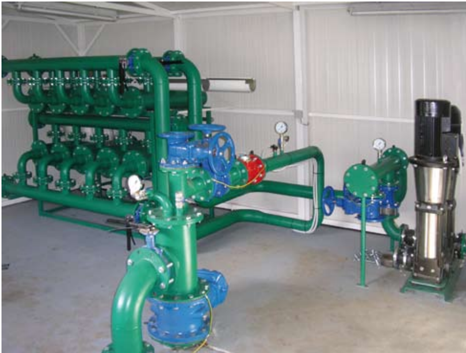
Kútfej képe a szűrőrendszerrel és szivattyúkkal
